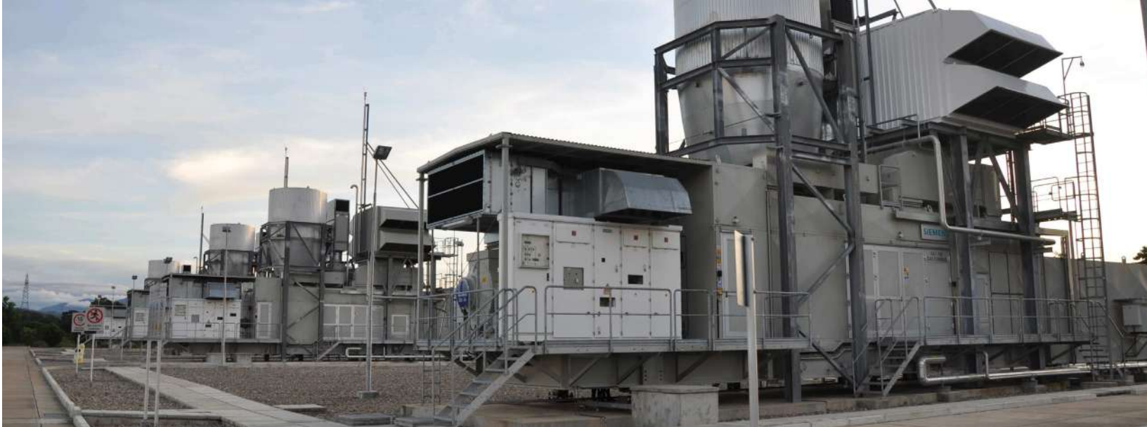
Foto: Termoeléctrica Entre Ríos, ENDE, 2018
